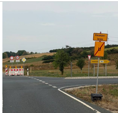
Bild 6: Die Beschilderung weist Vincenzenbronn weiterhin aus. Folgen Sie weiter dieser Richtung und nicht der Umleitung des Durchgangsverkehrs.
